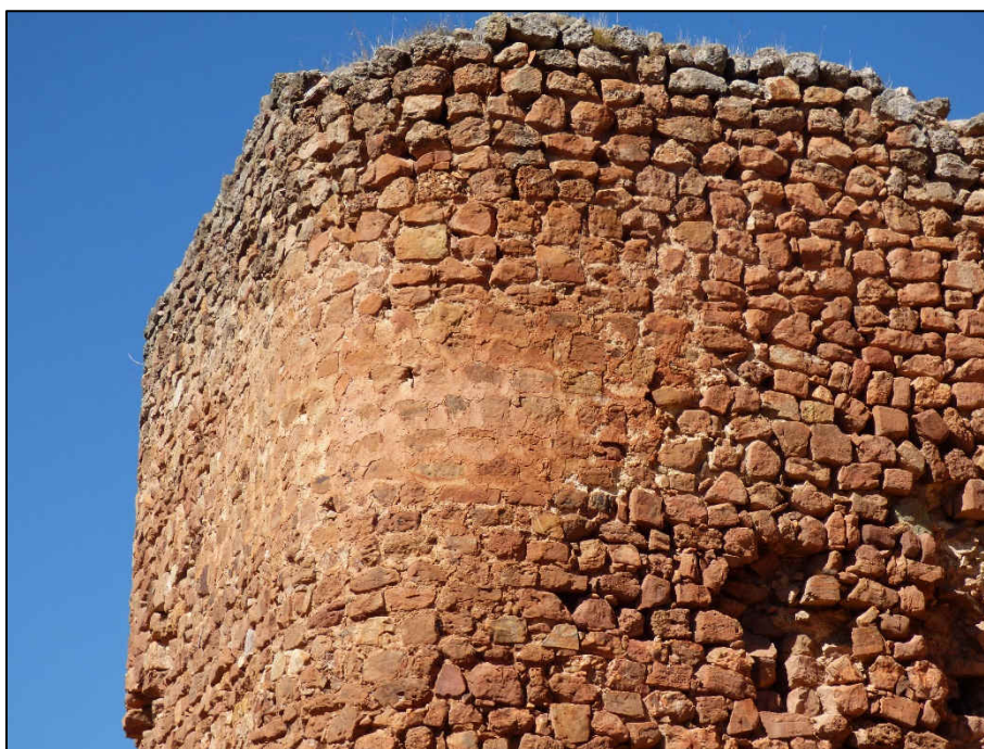
Vista de la Mamp1.Mont en la unión del Lienzo 4 y 5, con los restos del revestimiento
