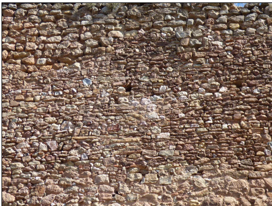
Vista de la Mamp7.Mont en el Lienzo 2, rellenando las pérdidas del muro original
