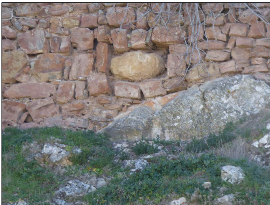
Detalle de una de las cámaras de tiro, hoy cegada, realizada con el Silla3.Mont
