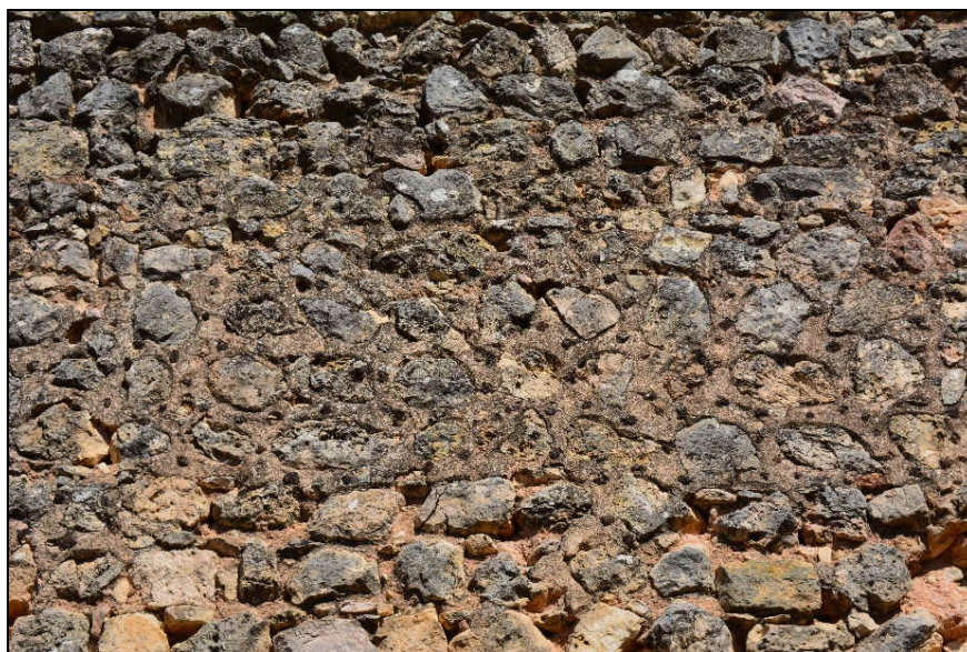
Muralla en cremallera de Uclés, revestimiento con moteado de escorias en las juntas
