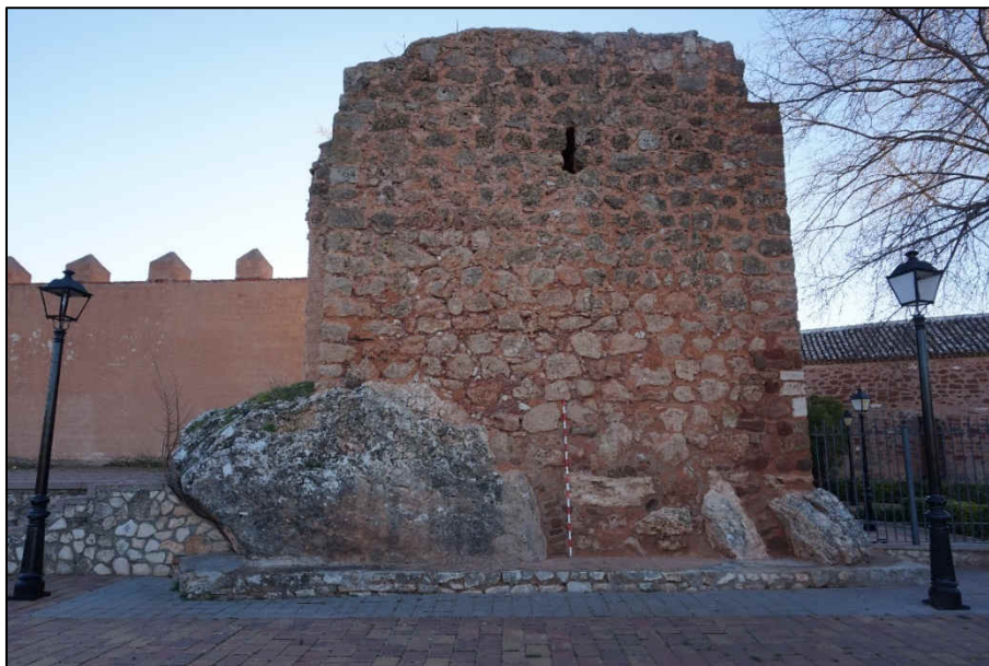
Torre 1, frente norte, realizada en con la Mamp1.Alb y posteriormente reparada
