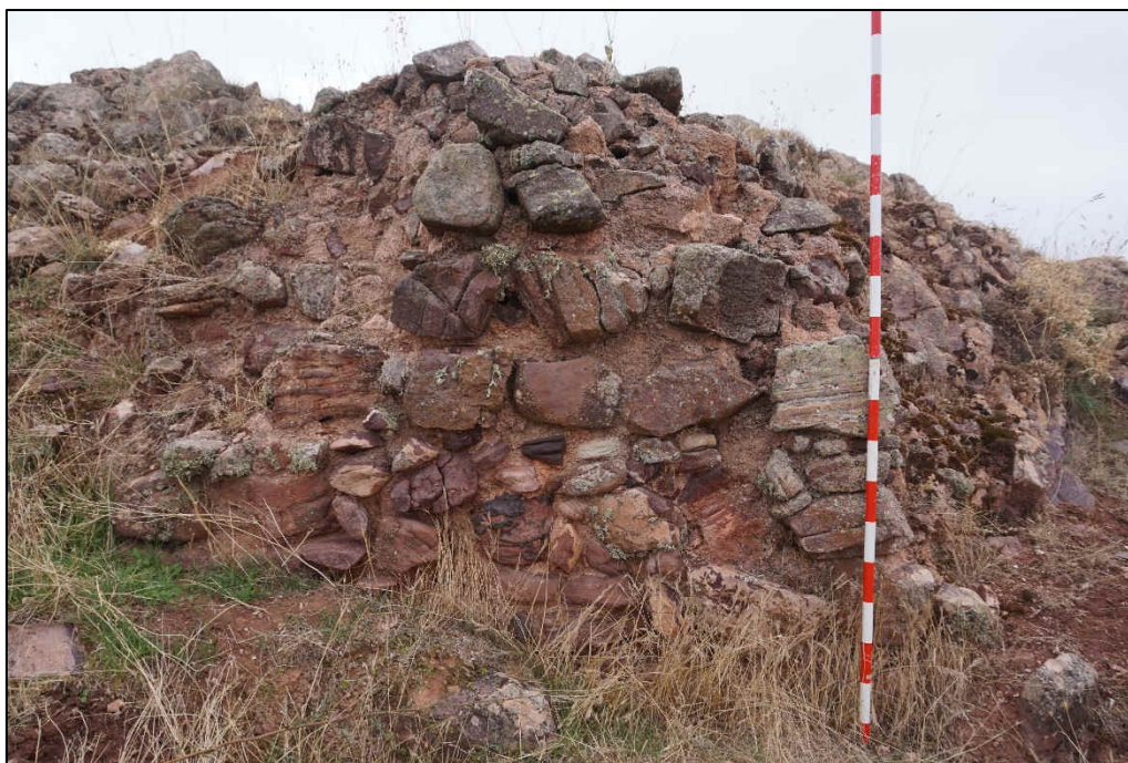
Mamp1.Ezn en la Torre 6
