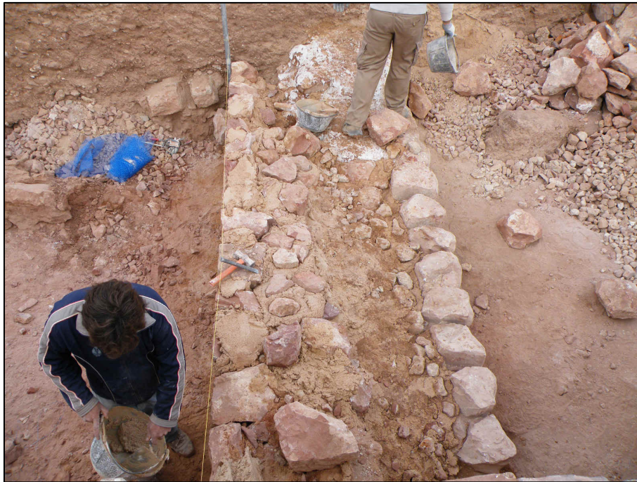
Realización de un muro mediante encofrados perdidos de mampostería de arenisca en el conjunto arqueológico del castillo de La Estrella de Montiel
