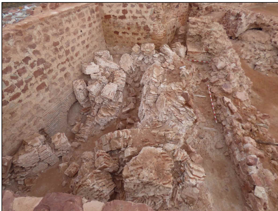
Derrumbe de la bóveda de la torre del Homenaje
